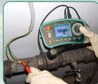
Sprawdzanie połączeń wyrównawczych
