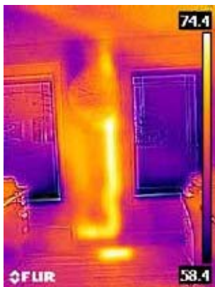
Wykrywanie gorącej rury ściekowej w ścianie
